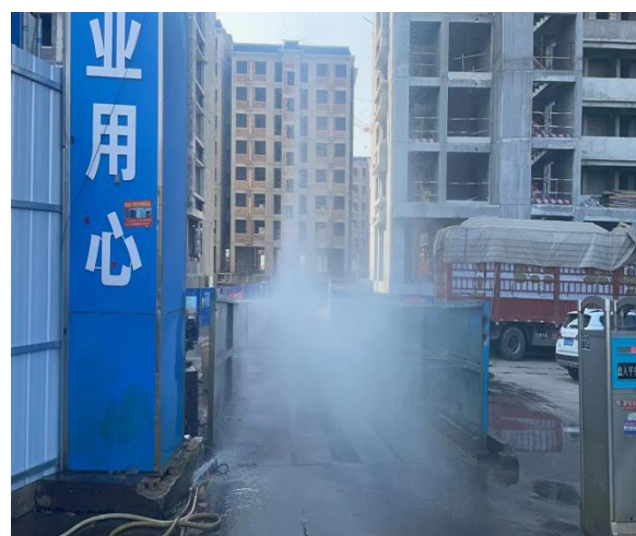
洗车沉淀池（依托二期项目）
